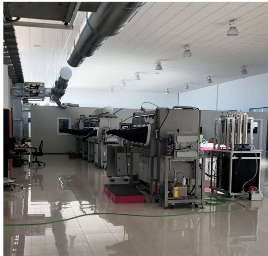
6- Cabinas de guantes usadas en aplicaciones de fabricación de baterías.
