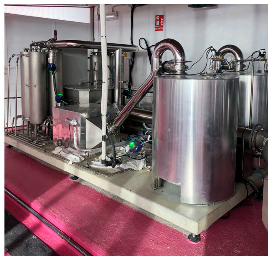
10-Unidad de purificación de alta capacidad para la reducción de los niveles de humedad en sala seca de 200m 3 .
