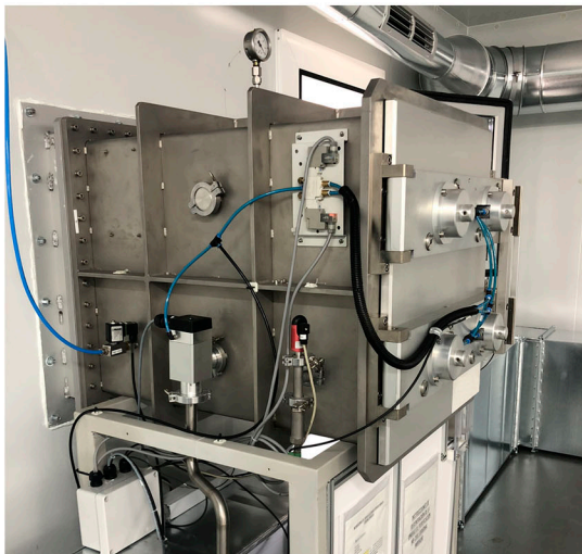
1-Antecámara de comunicación entre cabina de guantes y sala seca de 200m 2 .
